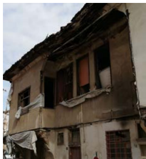
Metruk binanın çökme tehlikesi taşıdığı vurgulandı.
