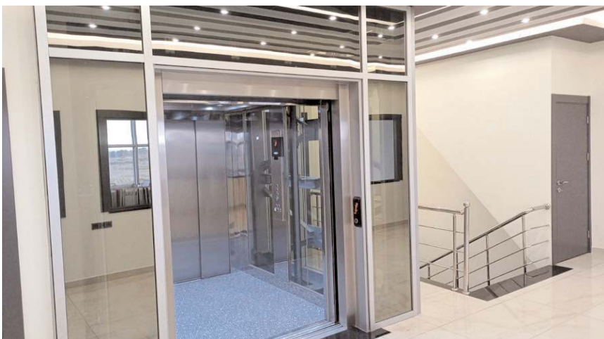
Firma asansörlerin montaj, revizyon ve periyodik bakımlarını yapıyor.
