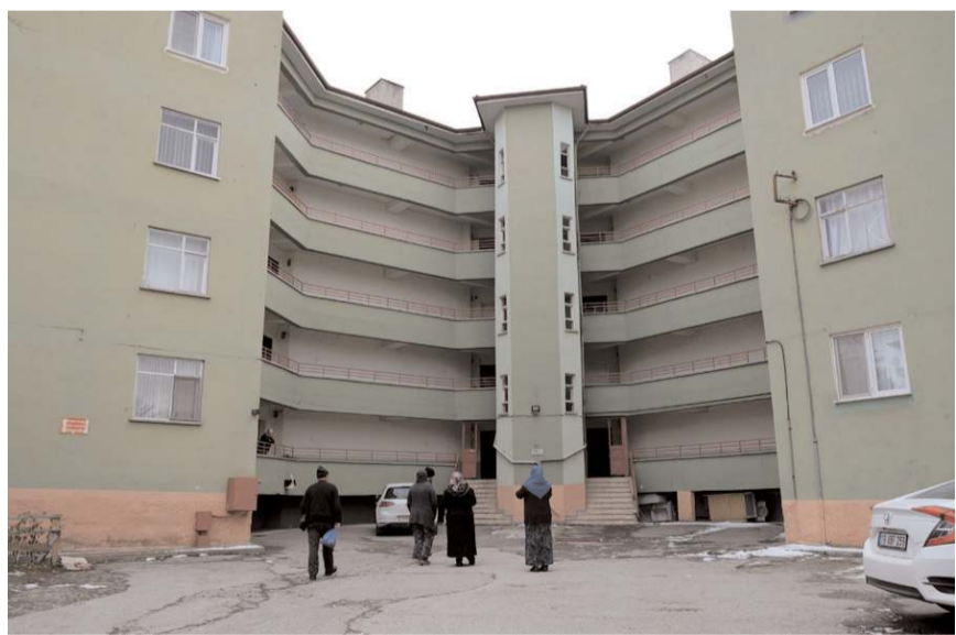
Deprem sonrasında Mimar Sinan Mahallesi'nde Ünal Apartmanı'nda çatlaklar oluştu.
