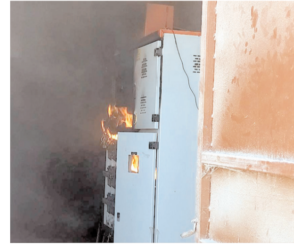
Trafonun yandığını gören vatandaşlar itfaiyeye haber verdiler.
