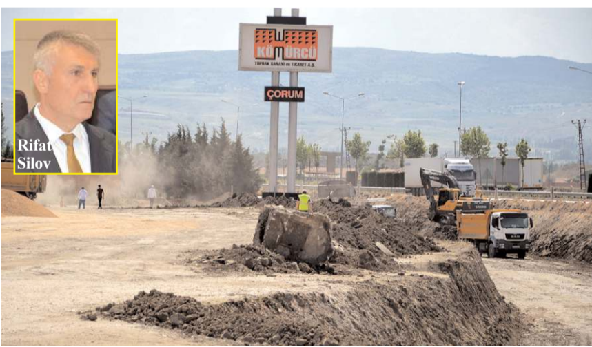
Kavşak projesi 4,2 km uzunluğunda bağlantı yolları, toprak tesviye, sanat yapıları, köprü ve üstyapı işlerini kapsıyor.
