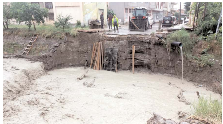
İnşa halindeki köprü'nün kalıplarını sel suları yıktı.
