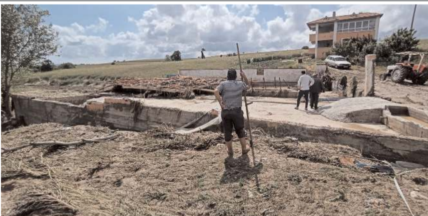
Sel nedeniyle Doğu Mahallesi'nde bir ahır yıkıldı.
