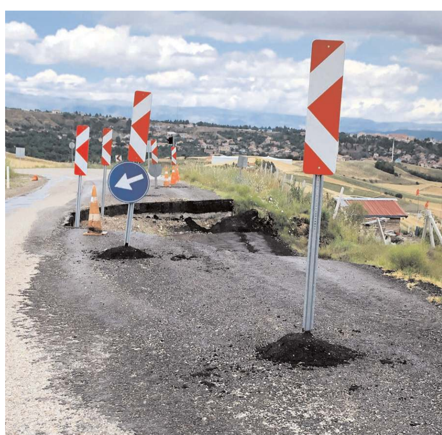
Oğuzlar-İskilip yolu 2'nci kilometresinde bulunan alan 6 ay önce çöktü.
