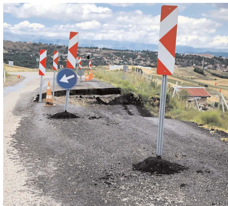
Oğuzlar-İskilip yolu 2'nci kilometresinde bulunan alan 6 ay önce çöktü.
