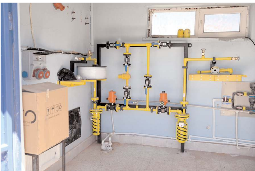
Klor ölçümleri ise SKADA sisteminden 24 saat kontrol edilebilecek.
