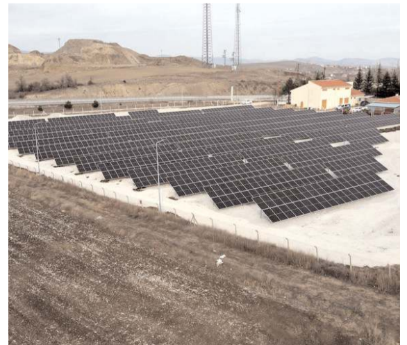
Tesis Çorum Belediyesi'nin Eskişehir köydeki pompa istasyonuna kuruldu.
