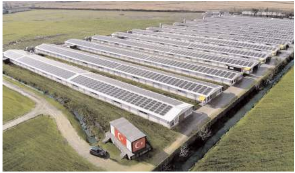
Güneş Enerji Santrali projesi depolamalı özellikle olacak.
