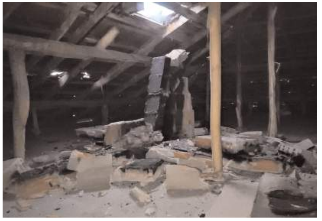
Yıldırım düşen çatıda maddi hasar meydana geldi.
