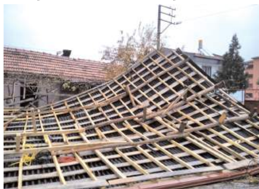
Fırtınaya dayanamayan bazı binaların çatıları uçtu.
