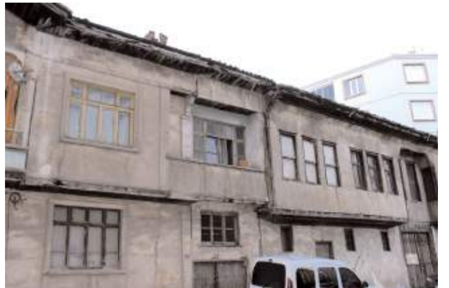
Sokak üzerinde bulunan metruk evler madde bağımlıların mekanı olmuş.
