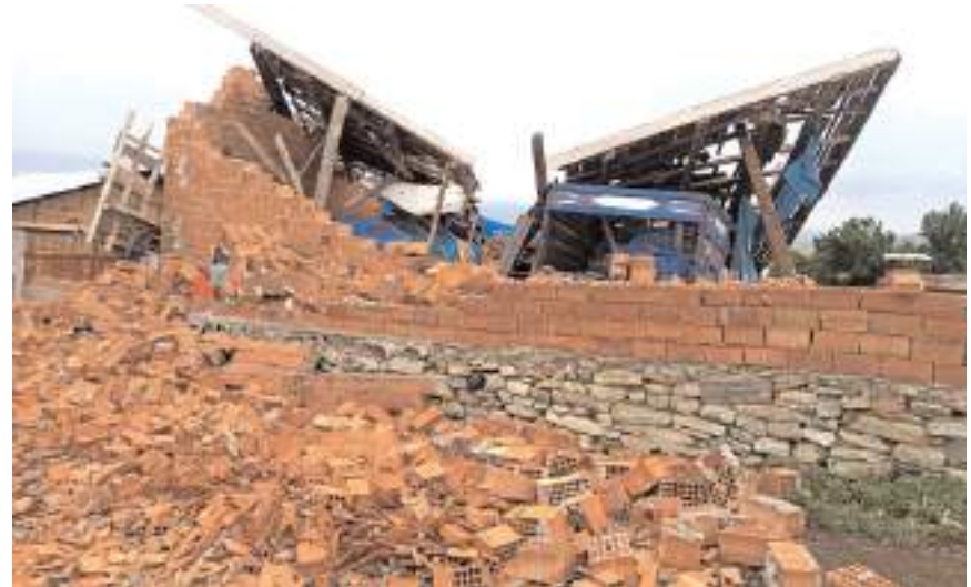
Hortum içinde traktör ve çeşitli tarım aletlerinin bulunduğu garaj yıktı.
