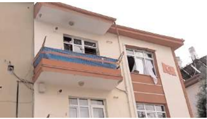
Olay Ulukavak Mahallesi'nde bir binanın üçüncü katında meydana gelmişti.
