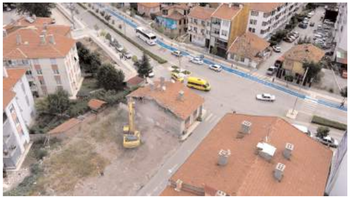
Akşemseddin Caddesi ile Recep Tayyip Erdoğan Caddesi'ni birbirine bağlayacak 20 metre genişliğindeki bulvar için kamulaştırma ve yıkım çalışmalarına devam ediyor.
