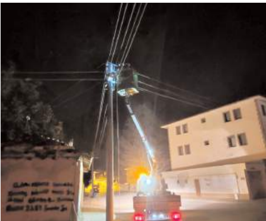
YEDAŞ ekipleri bölgedeki elektrik akımını keserek binaya yaslanan direğe müdahale etti.
