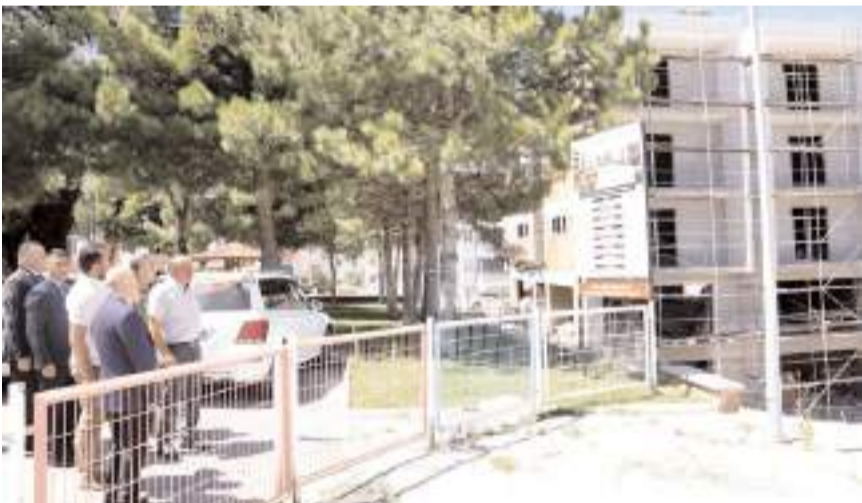
Vali Dağlı, Demek Başkanı Nurettin Aksoy'dan vakfın çalışmaları ve yapımı devam eden cemevi inşaatı hakkında bilgi aldı.
