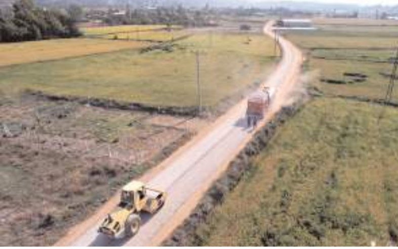
Osmancık Belediyesi, Güney Mahallesi'nden Toprak Sanayi Bölgesine kadar olan 3 kilometrelik eski Çorum yolunu iyileştirdi.
