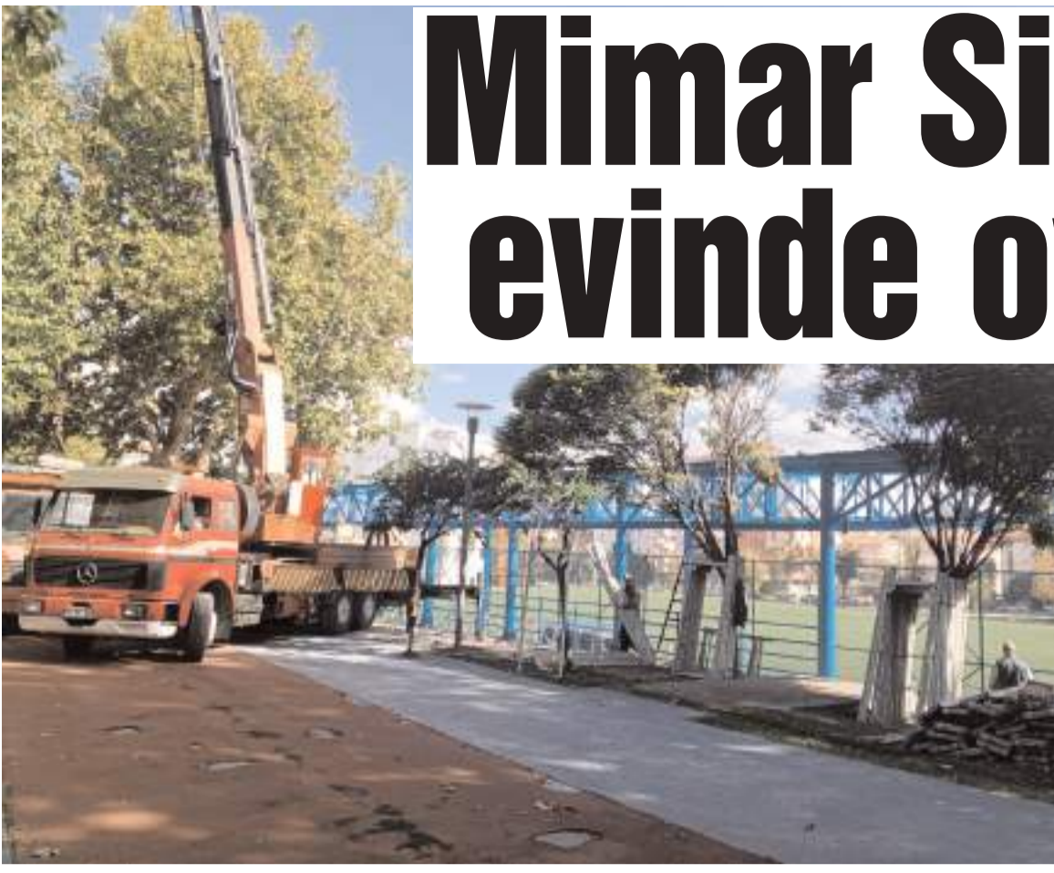
Mimar Sinan sahası tribün çatı kaplaması çalışmaları yüklenici firma tarafından devam ediyor
