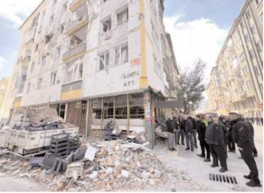
Vali Çalgan, 5 binada hasar oluştuğunu söyledi.
