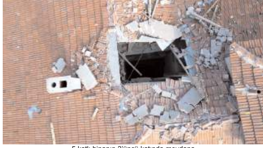
5 katlı binanın 3'üncü katında meydana gelen patlamanın şiddetiyle çatıda delinmiş.
