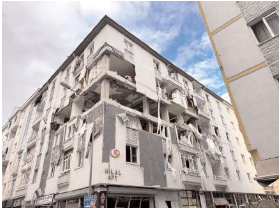
5 katlı Hilal Apartmanı patlamada büyük hasar almıştı.
