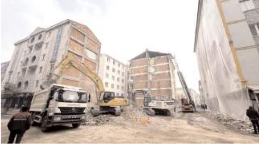
Patlamada ağır hasar alan bina belediye ekipleri tarafından yıkılmıştı.
