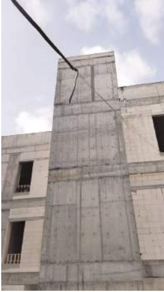
Olay Çorum Devlet Hastanesi inşaatında meydana geldi.
