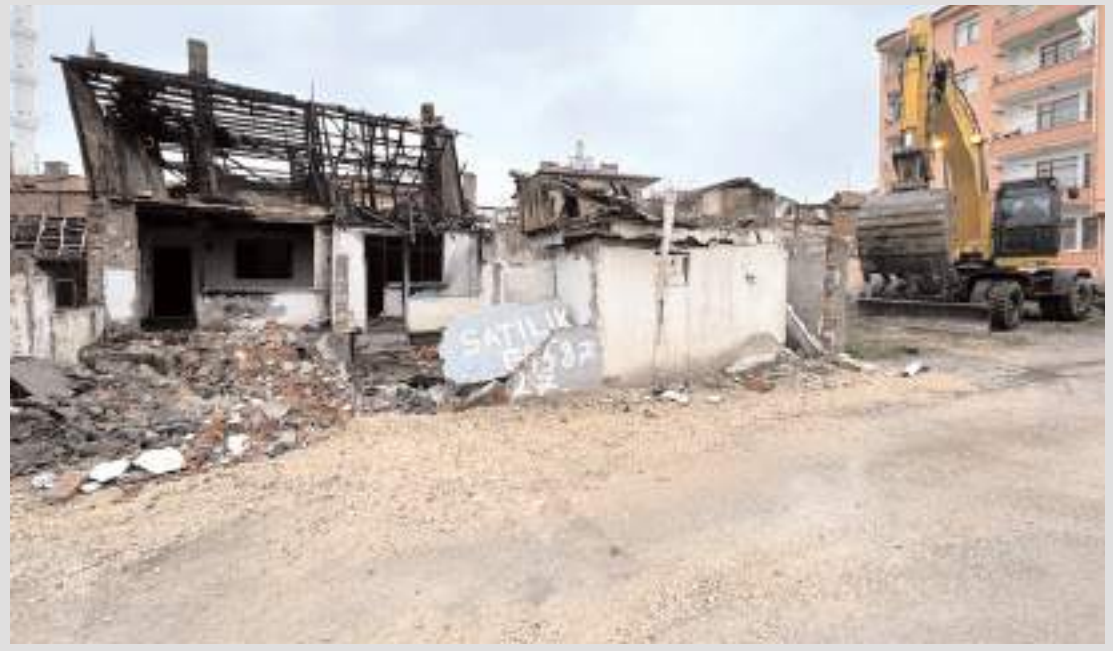
Belediye can ve mal kaybına sebebiyet verebilecek göçme ve yangın tehlikesi olan ciddi tehlike arz eden yapıları yıkıyor.
