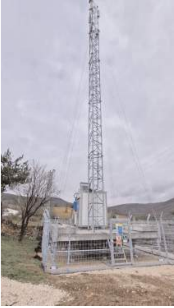
İlçeye baz istasyonu kuruluyor.
