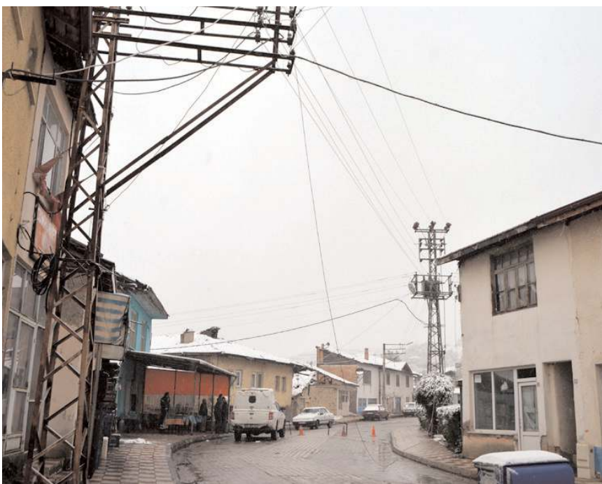
Dodurga Mahallesi Buhara Caddesi'nde kopan elektrik teli yola düştü.
