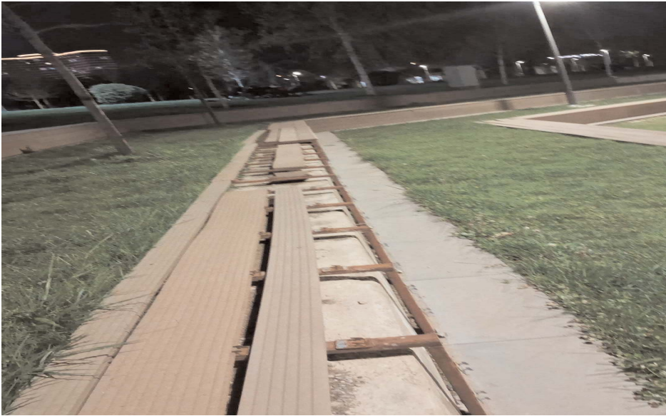
Bankların kırık olması nedeniyle vatandaşlar kullanamıyor.
