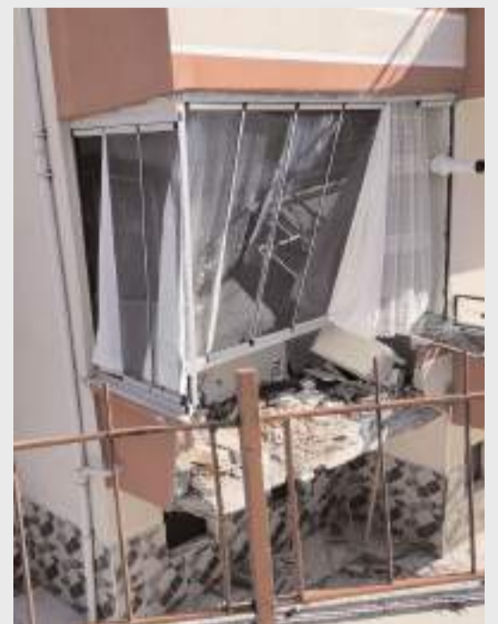
Kazada binada hasar oluştu.
