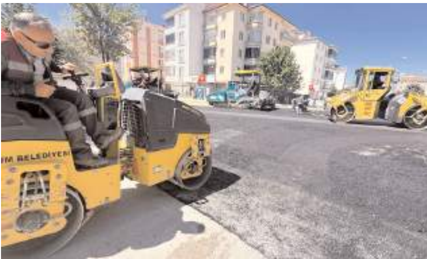
Alt yapısı yenilenen sokağın asfaltı döküldü.
