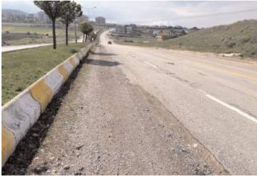
Dr. İlhan Gürel Caddesinin Silmkent bölümünde yolda bozuk bölümler bulunuyor.
