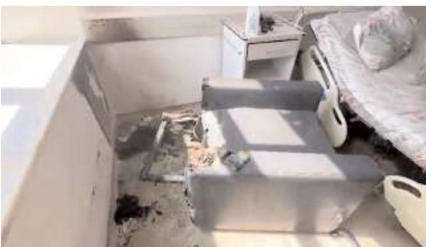
Yangında odada maddi hasar meydana geldi.
