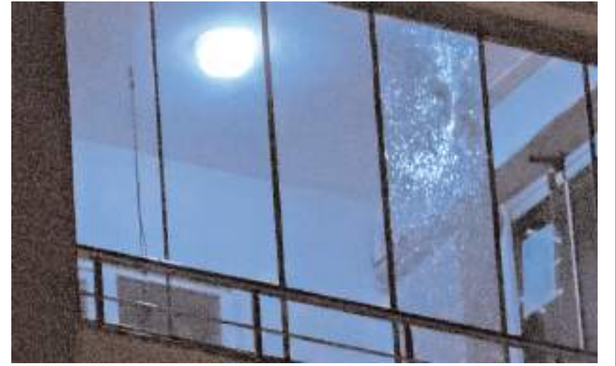
Olayda dairenin balkon camında hasar meydana geldi.
