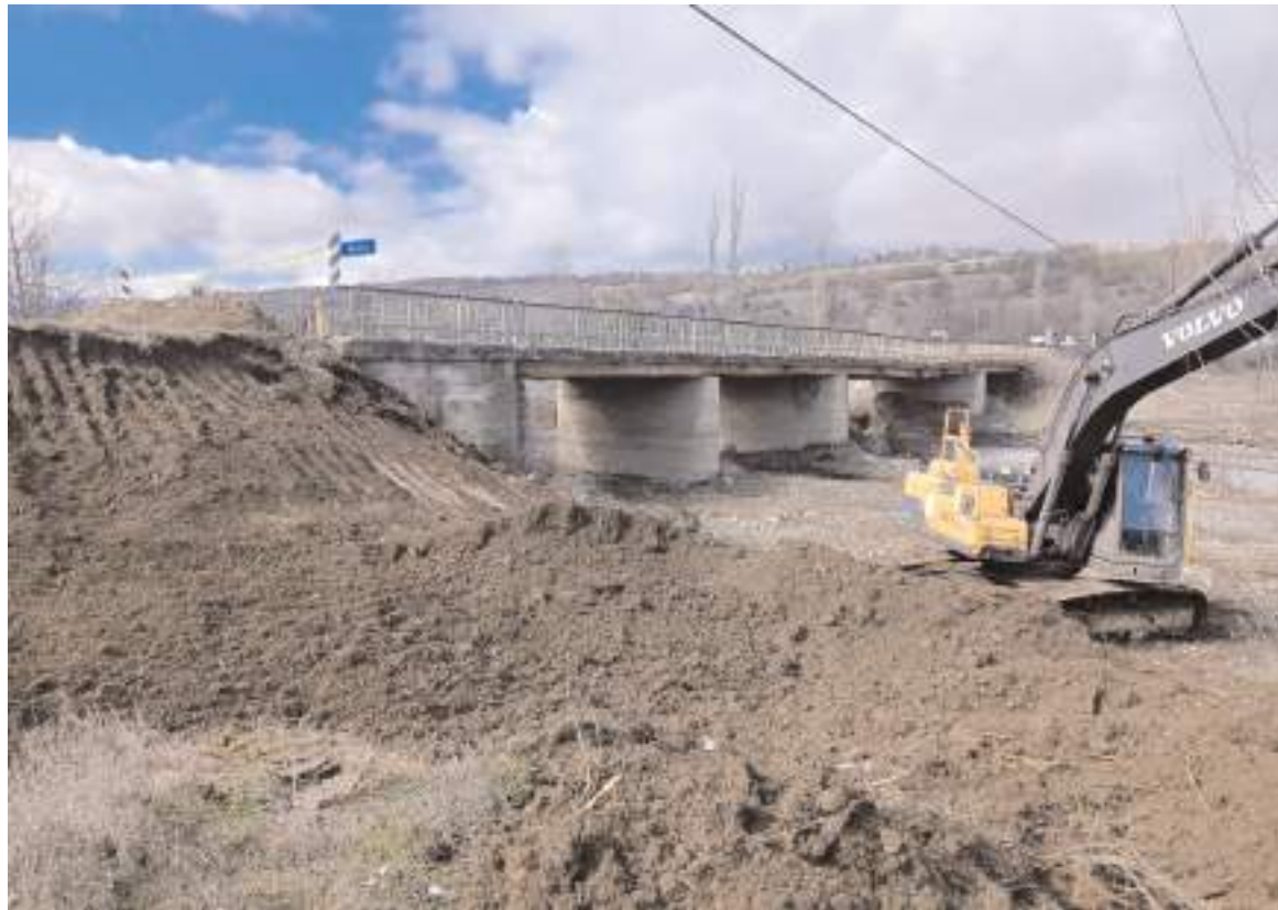
Çomu Çayı köprüsü ayağının yıkılması nedeniyle trafiğe kapatılmıştı.
