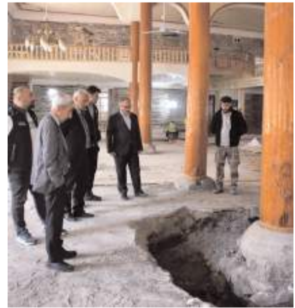
İskilip Belediye Başkanı İsmail Çizicki, Ulu Cami'de devam eden restorasyon çalışmalarını yerinde inceledi.
