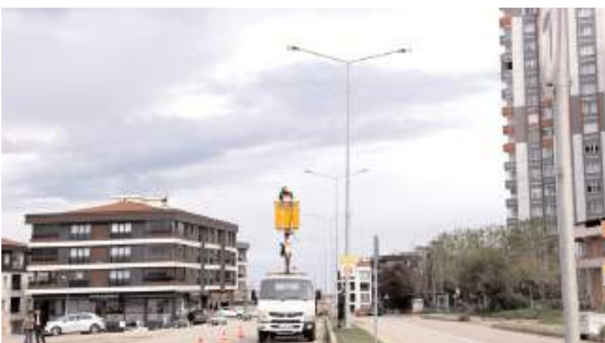
Proje kapsamında yaklaşık 600 bin aydınlatma armatürü led sistemlere dönüştürülecek.
