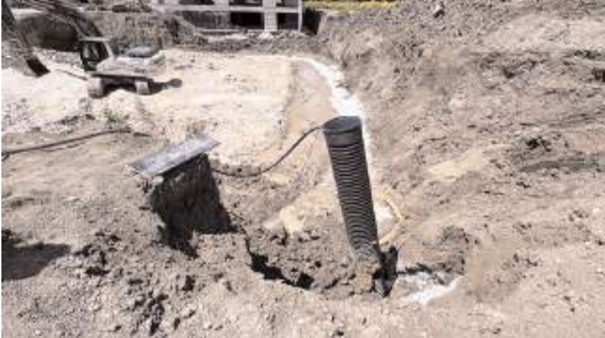
İnşaatın temel kısmında yürütülen çalışmalar sırasında toprak kayması yaşandı.
