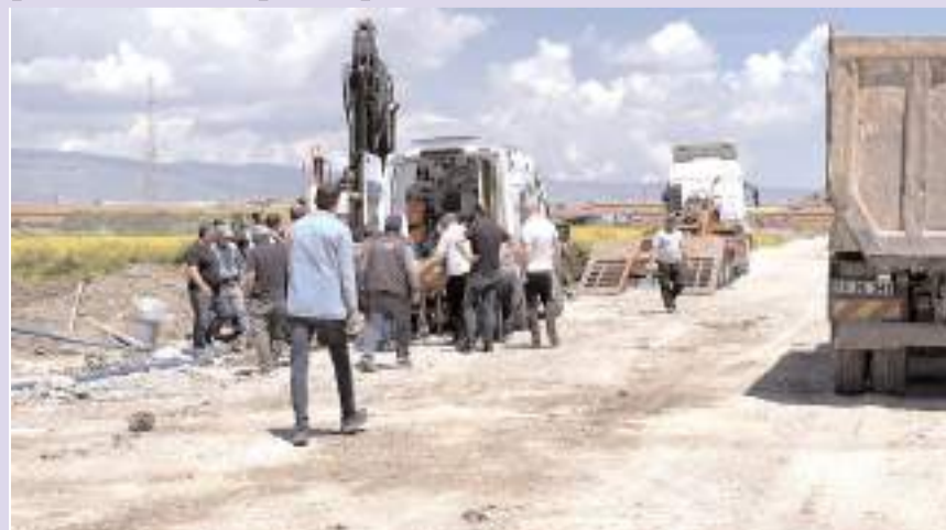
Olay, Prof. Dr. Necmettin Erbakan Caddesi üzerinde bulunan bir inşaat alanında meydana geldi.
