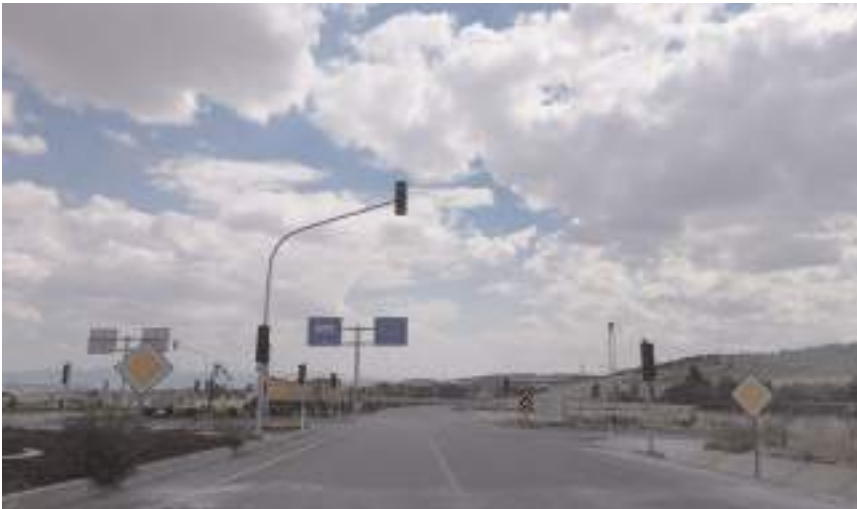
Sinyalizasyon sisteminin çalışması için ilgili kurumun elektrik hattını çekmesi bekleniyor.
