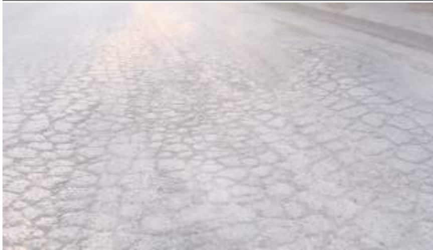
Asfaltta bozulmalar meydana gelmiş.
