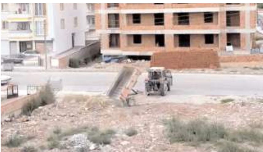
Araziye kaçak hafriyat dökülenler tespit edildi.
