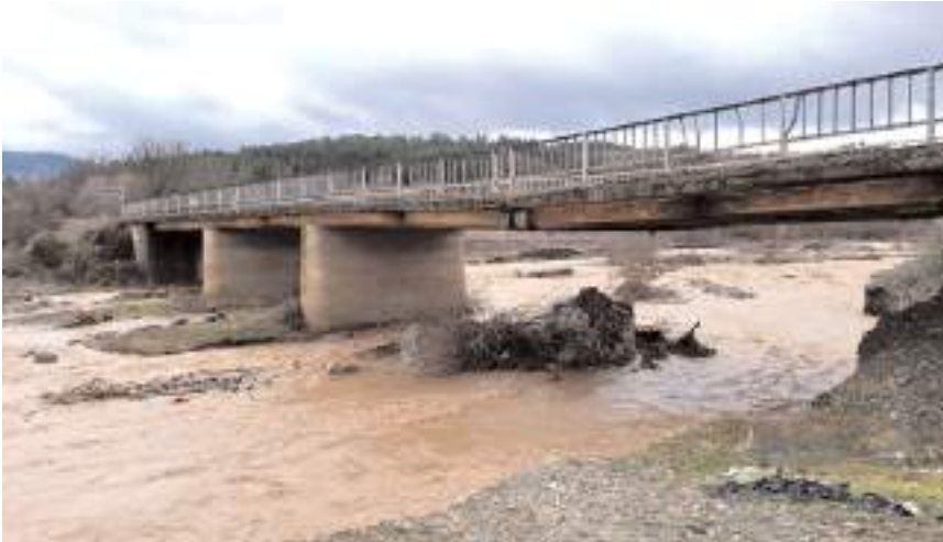
Köprü'nün bir ayağı Şubat ayında yıkılmış, trafiğe kapatılmıştı.
